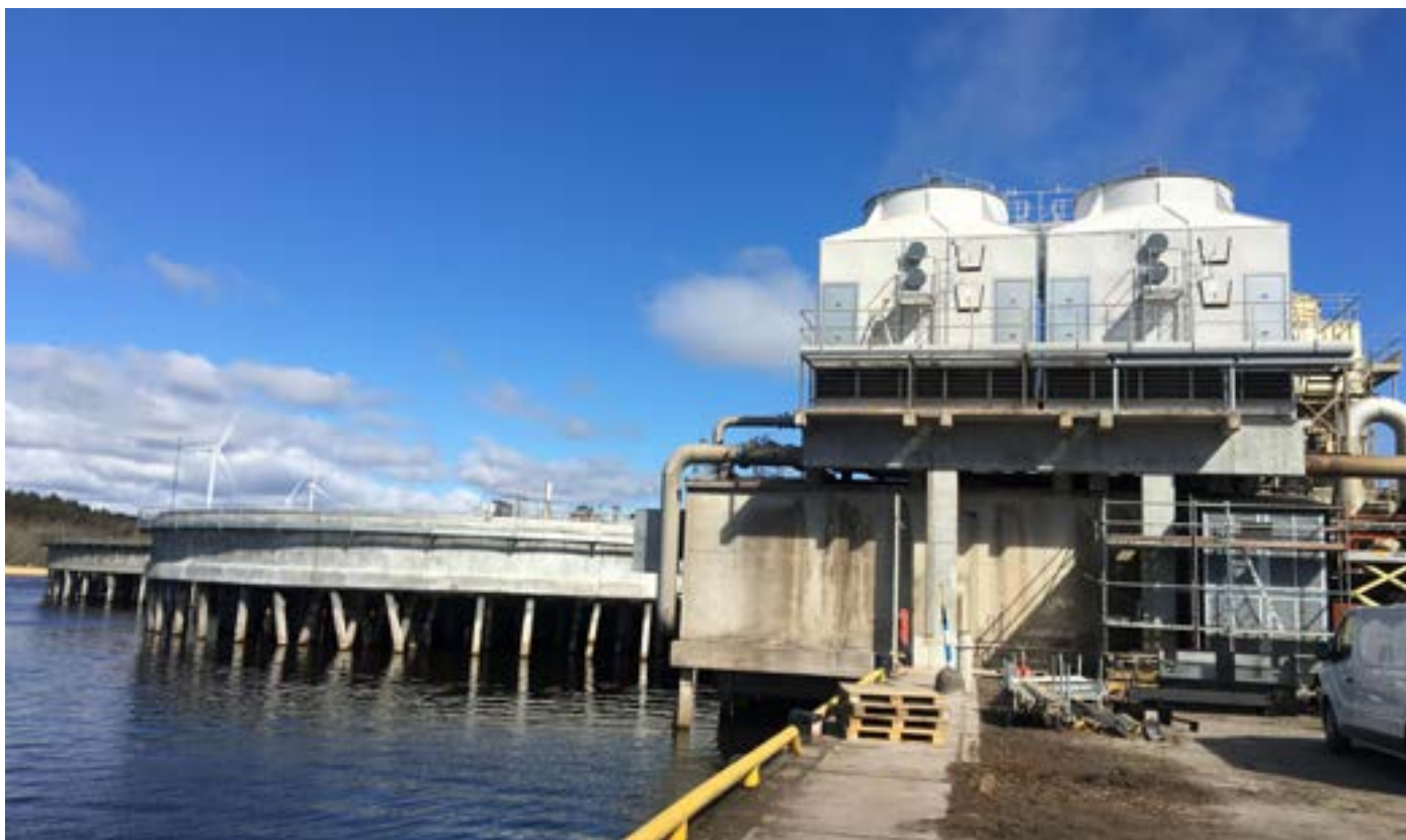
Nyrenoverad försedimenteringsbassäng och 2 nya fina kyltorn
