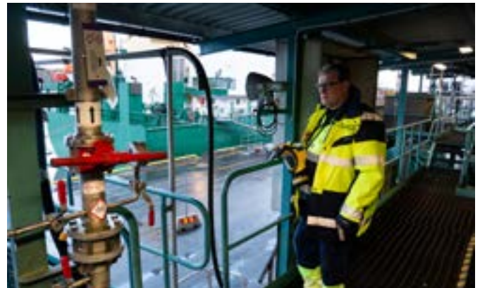
Avgasning av SO2 ledningar
