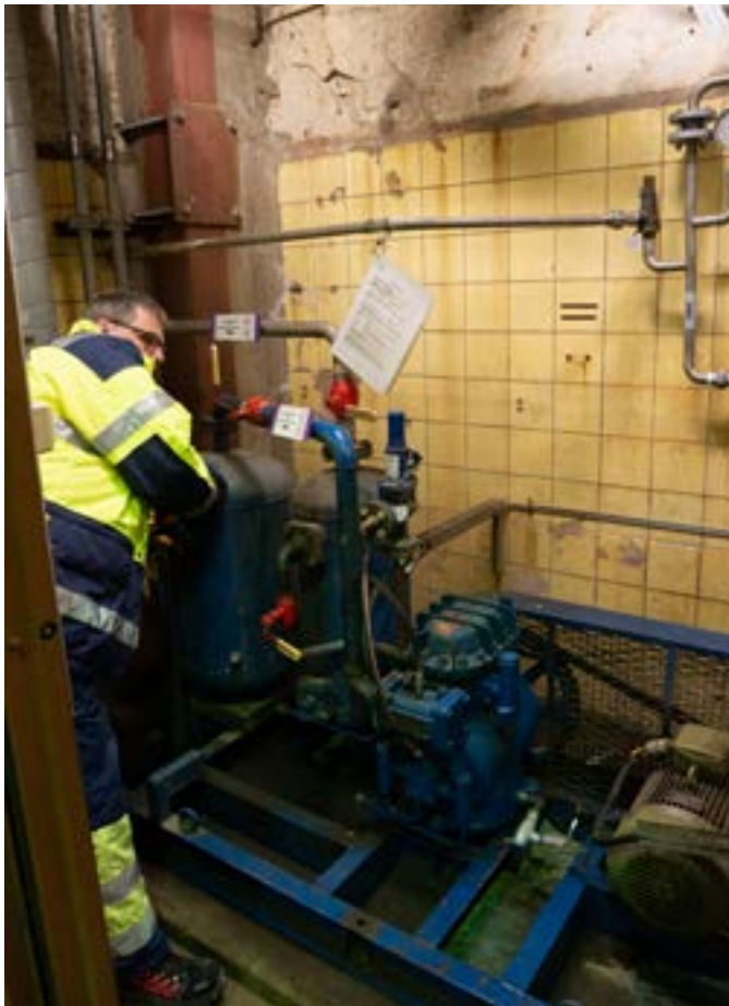
Bosse stänger av lossningskompressorn efter avslutad SO2 lossning
