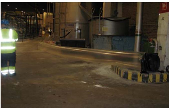
Slangen som vi körde in lite luft till dem i ställverket för det var så syrefattigt och varmt för att dem skulle få lite bättre temperatur. Entreprenörerna blev verkligen nöjda.
