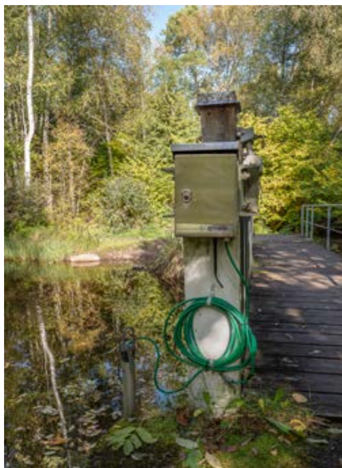
Vattennivån kan avläsas på distans vid Vällendammen
