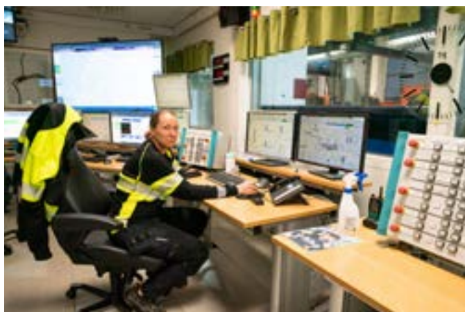
Malin Rosenblom övervakar processen i kontrollrummet, härifrån styrs hela TMP-fabriken.
